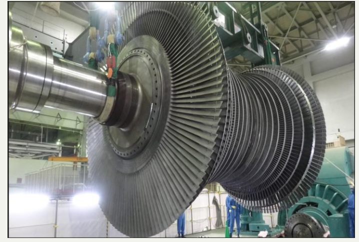
日本原子力発電様 東海第二発電所2号機
