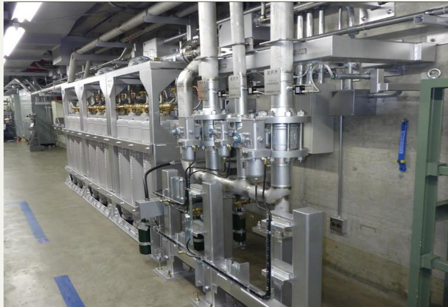
東京電力ホールディングス様 柏崎刈羽原子力発電所6, 7号機
