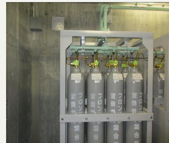
ガス消火設備設置耐震評価 写真:北陸電力様提供
