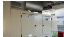
非常用発電設備
