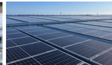
屋上太陽光パネル
