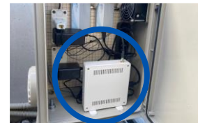
デマンドコントロール(集中制御装置)
