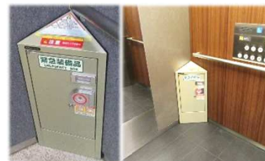
EV内緊急装備品の設置 (A-PLACE青山他10物件)
