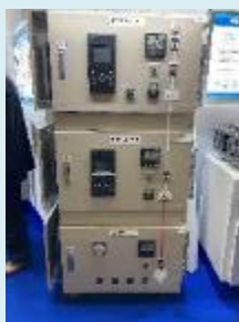
＜変電＞ 非常用 仮設配電盤
